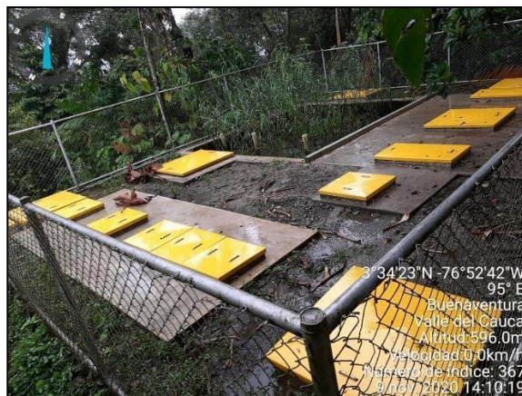
Foto 1. Sistema Séptico Campamento Yatacué
