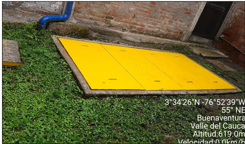
Foto 1. Sistema Séptico Oficina Automotriz No. 2
