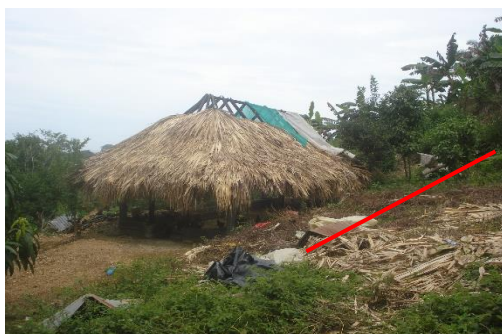
Figura 16A, gallinero visto lateralmente durante su construcción, se observa disposición inadecuada de residuos sólidos producto de la construcción.
